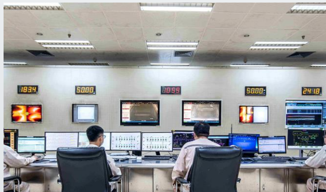
中央调度调控系统
